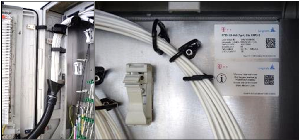
Abbildung 62: Gf-NVt 17gr (BF) Schutzschlauchführung
